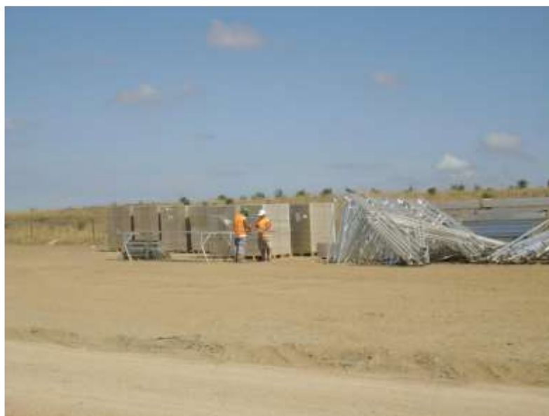
Imagen 11. Fotografía de instalaciones provisionales
